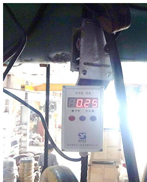
Hình 7. Cảm biến tải lắp ở nhánh cáp cuối tời nâng
